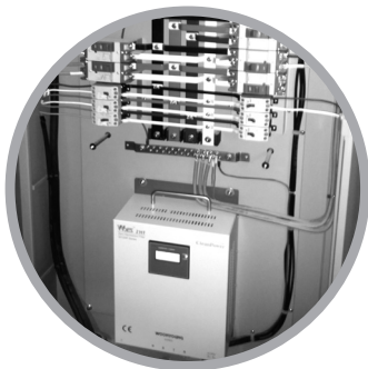
현장 설치 판넬
